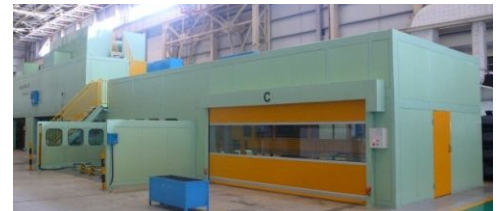
例)防音設備設置例
